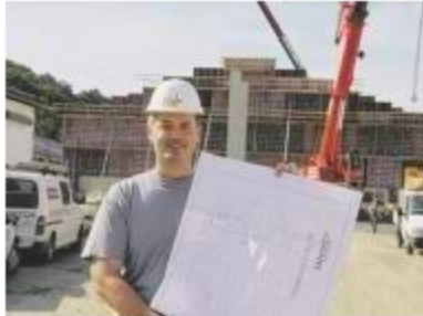
Im Bild Geschäftsführer Andreas Hütter vor der im Bau befindlichen Anlage. Foto: Roman Musch
